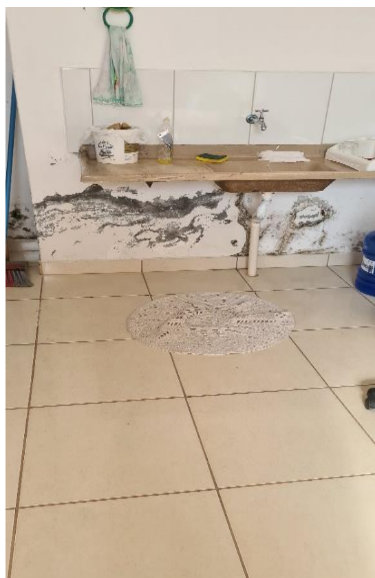
Umidade e mofo perto da pia
