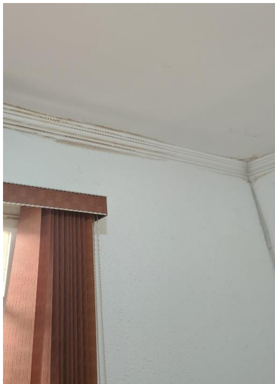
Teto com infiltração
