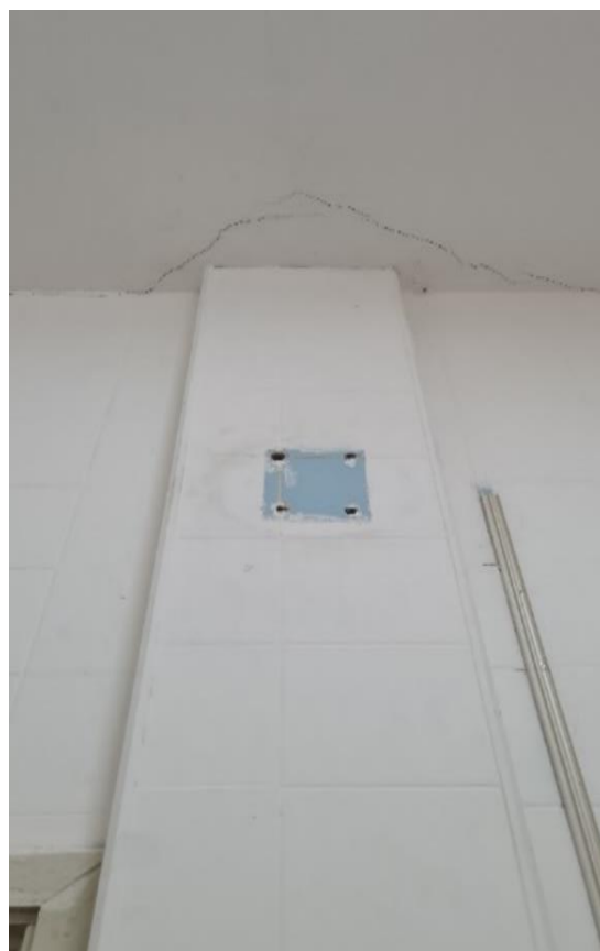
Trincas no teto
