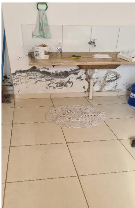
Umidade e mofo perto da pia
