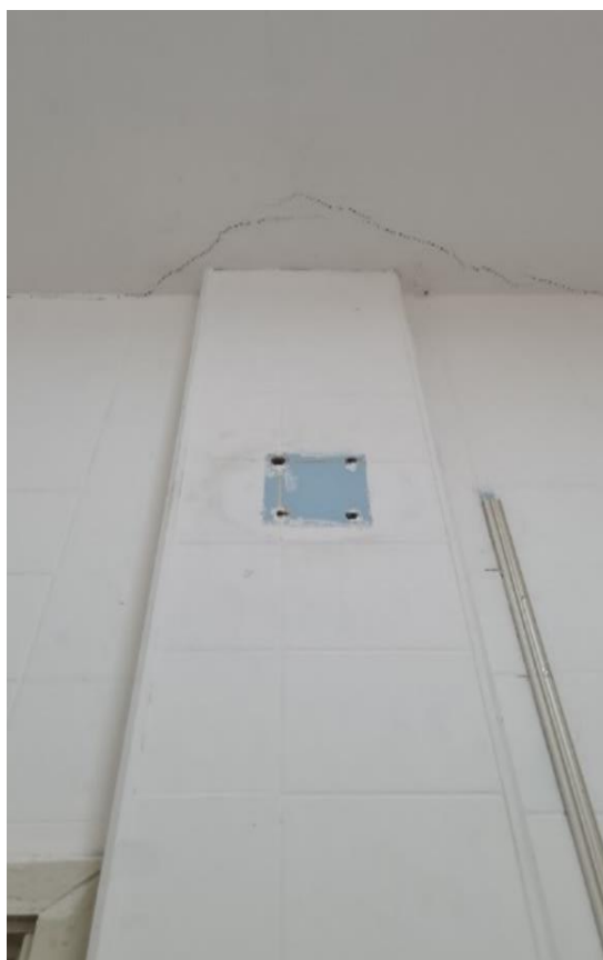
Trincas no teto
